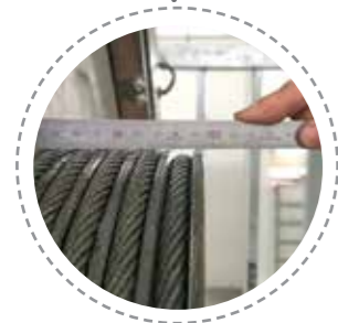
PULI BỊ MÒN BẤT THƯỜNG DO ĐIỀU CHỈNH SAI ĐỘ CĂNG CÁP
