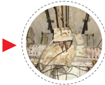
CÁP BỊ ĐỨT VÀ RƠI TRÊN ĐẦU CABIN
