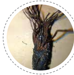
CÁP BỊ HƯ HỎNG VÀ BỊ ĐỨT
